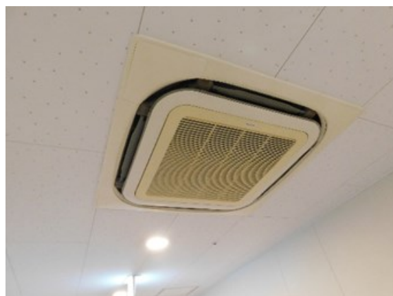
5F病棟 廊下 室内機
